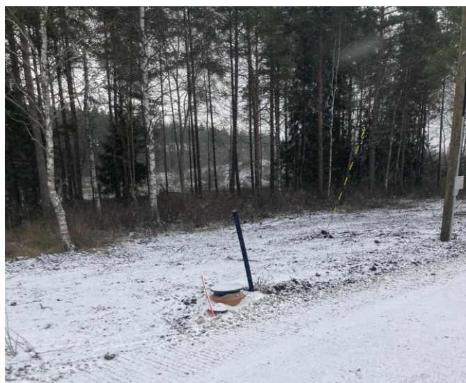
Foto 3. Kaljumetsa katastriüksuse liitumispunkt ühisveevarustuse- ja kanalisatsiooniga
