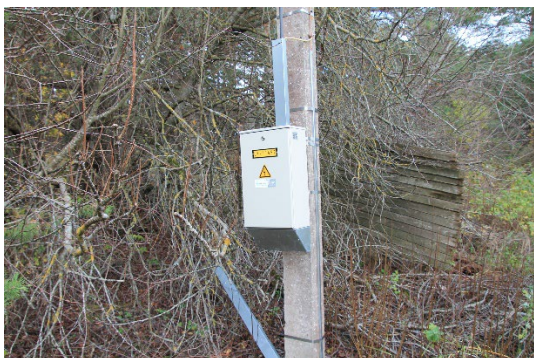
Foto 3 Olemasolev elektrivarustuse liitumiskilp Kõrgemäe tee 2 krundil
