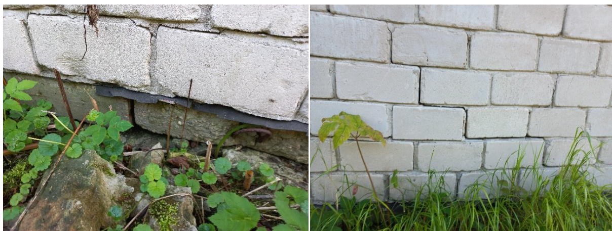
Fotod 6, 7. Vundamendis ja välisseinas olevad praod
