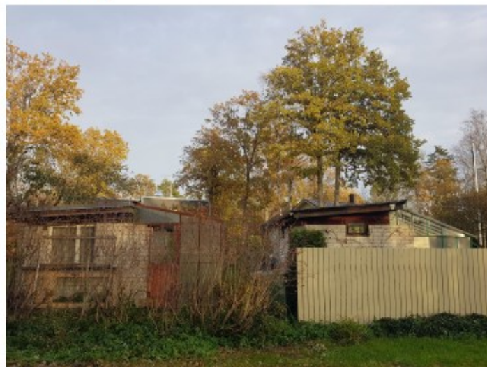
Foto 12: Vaade Tamme tn 6 ja Tamme tn 4 abihoonetele, mille vahele on planeeringuga ette nähtud tulemüür.
