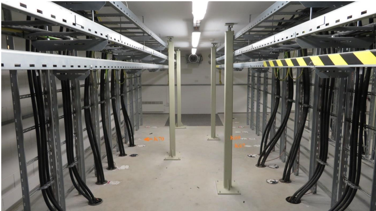
Foto 1. Tööstuse AJ 10kV JS III ja IV sektsiooni kaablikelder.
