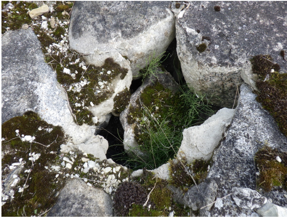
Foto 5. Kahjustunud kivikindlustis ülavee pool
