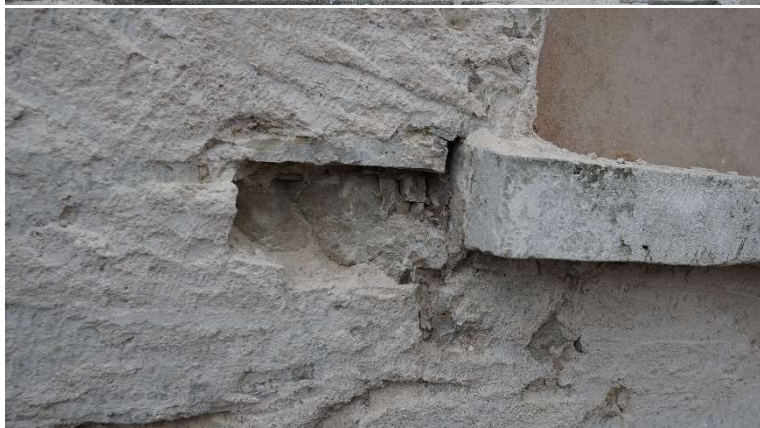
Foto 19 Murenenud kivi aknalaua kõrval
