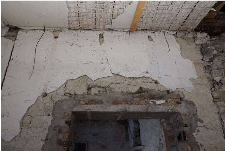
Foto 8 Pragunenud seinosa eelnevatel fotodel oleva ukseava betoonsilluse kohal (vaade edelast)
