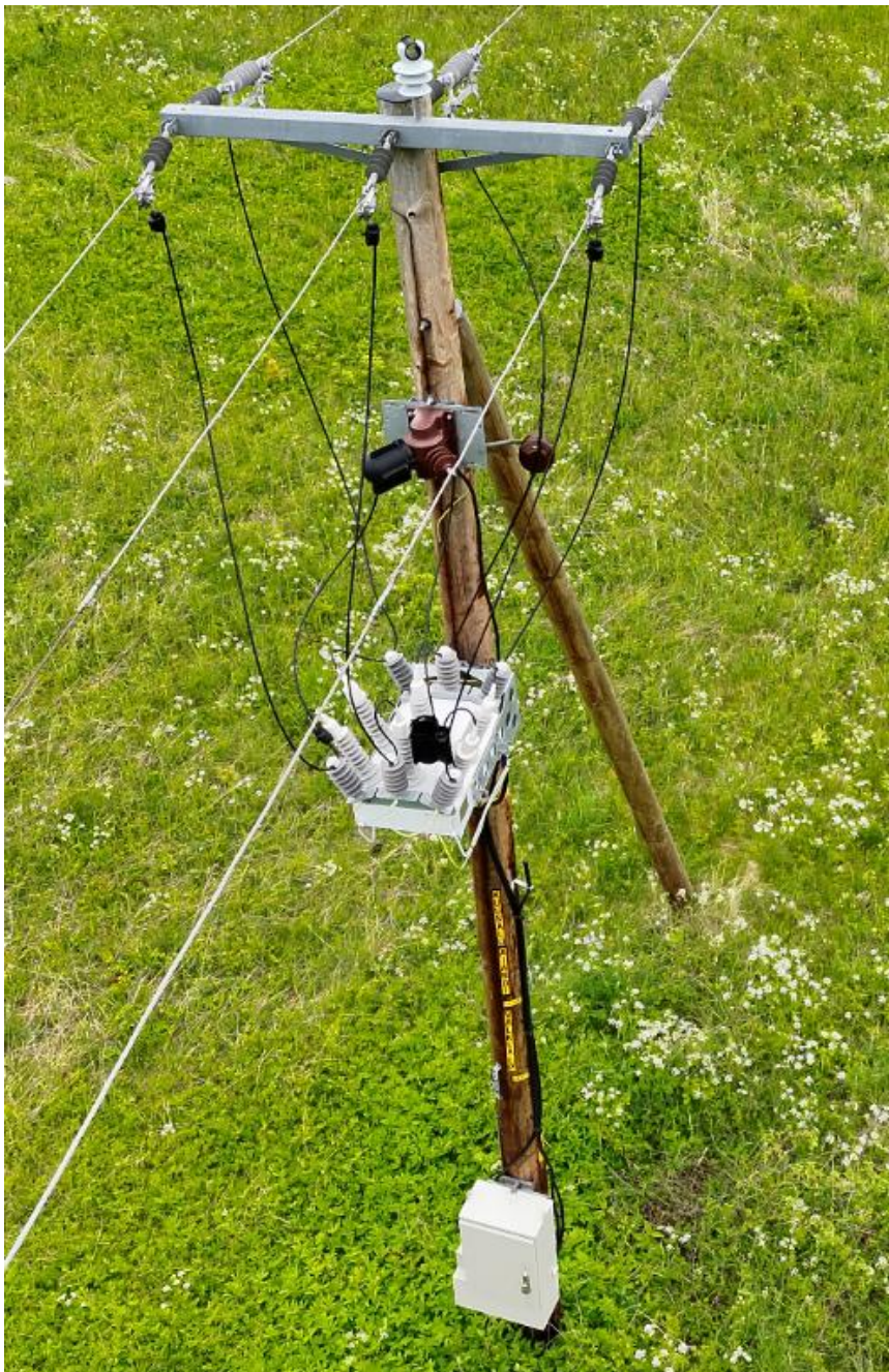
Joonis 3.1 – AJ Maria 10 kV haruliini mast nr 1, Valkla LP.
