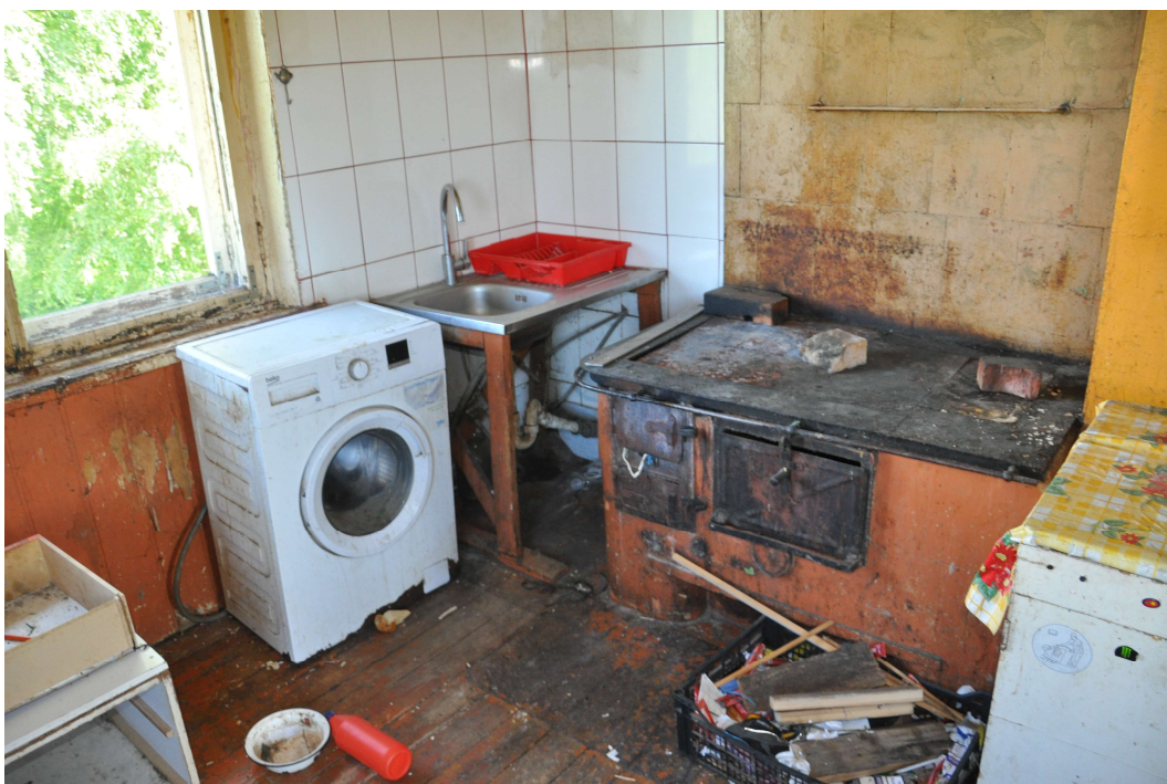
Foto 7 Elamu sisevaade, hoone on suures osas täidetud olmeprügiga
