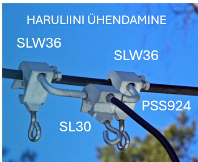
Joonis 3.1 Haruliini ühendamine mastil 87.
